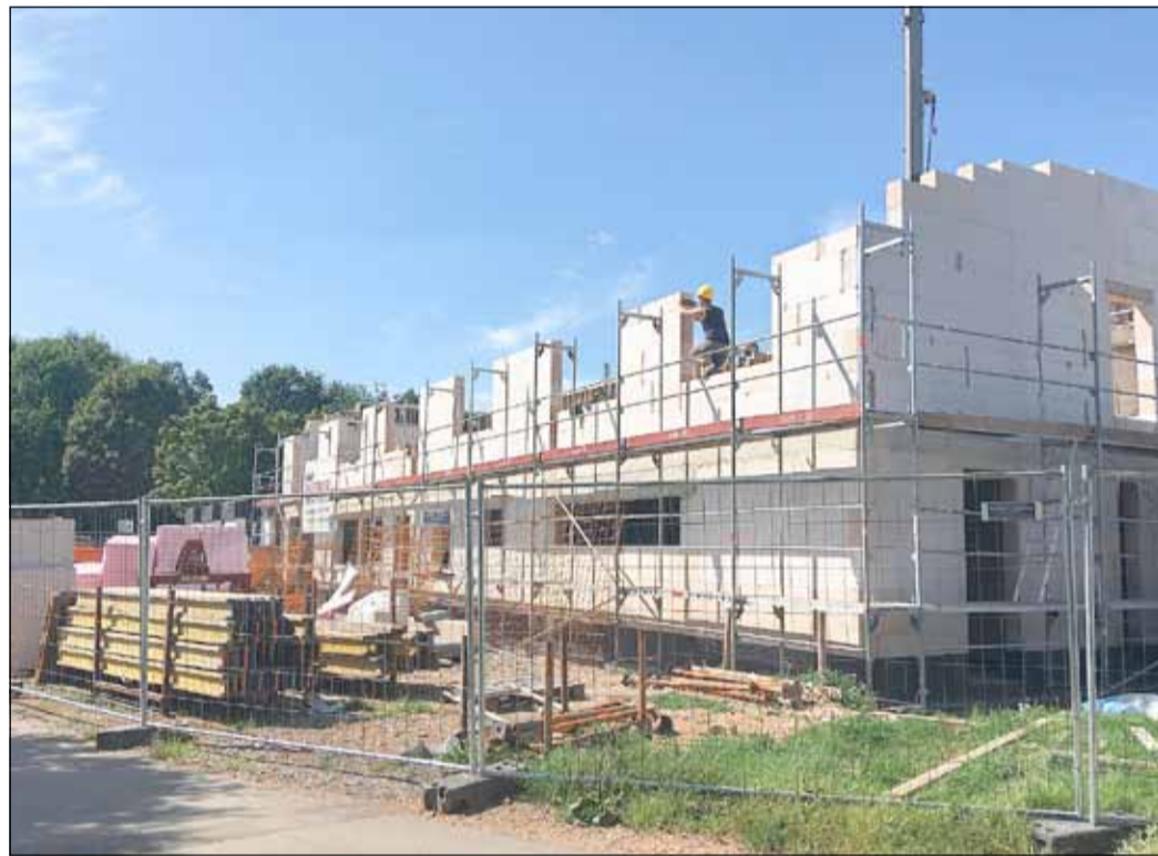
Noch vor dem Winter wird der neue Trakt der Seeverwaltung fertig sein. Ab Juni 2018 gibt es dann viel mehr Platz für die Verwaltung, DLRG und Segler. Foto: pdk
